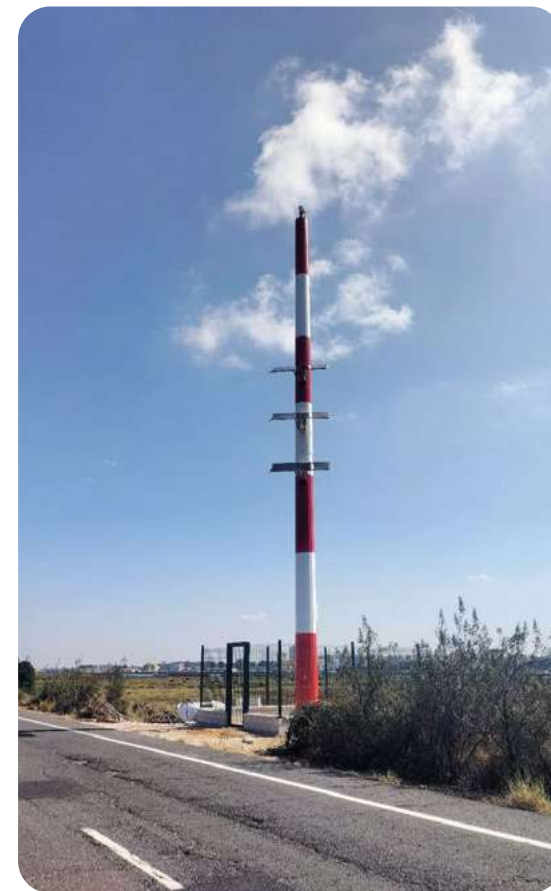
Cámara instalada en la carretera del dique.
