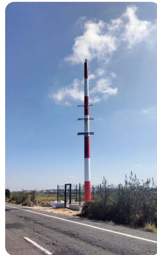
Cámara instalada en la carretera del dique.
